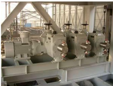
海上石油平臺：化學藥劑注入加藥裝置 絮凝劑、緩蝕劑、阻垢劑添加
